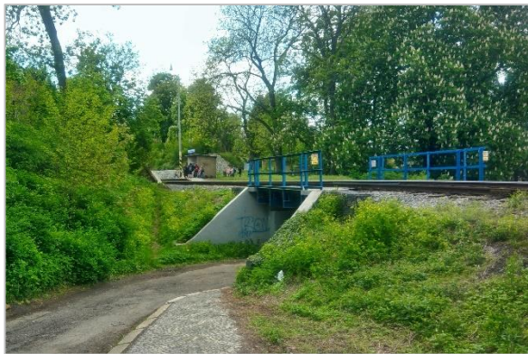
104/ Přístup z jižní strany: chodník ukončený před podjezdem za ním nepokračuje (viz foto vpravo)
