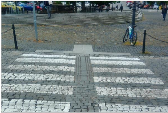
94/ Chybějící napojení signálního pásu na vodící linii uprostřed Karlova náměstí
